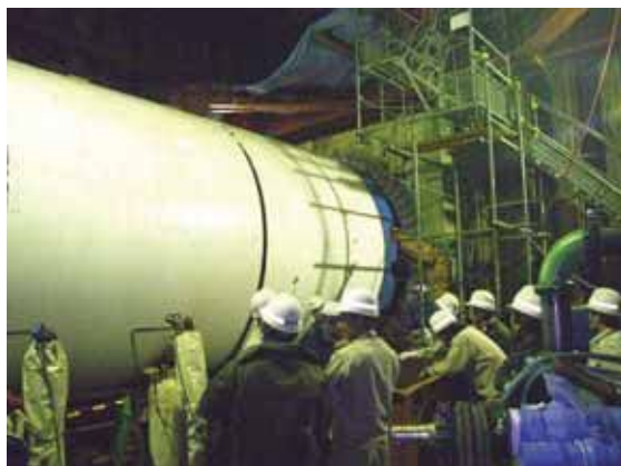
【雨天時越流水*対策】 鶴沼東部1号貯留管
